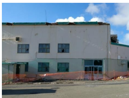
図3 中岳にある破壊された建物
