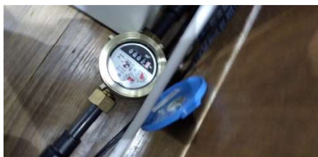
図3 流量計の写真
